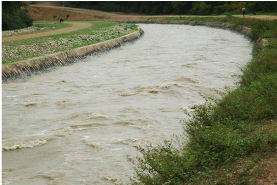
Fig. 4 Canal Alimentador de Tinajones, operando cerca al estado crítico, cerca de Chiclayo, Lambayeque, Perú.
